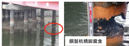
【重大な損傷の事例(橋梁)】
